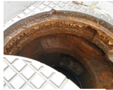
Oorzaak: slijtage in de onderopbouw.
